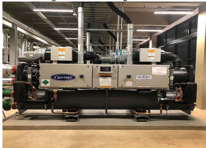
Figura 3: Central de Água Gelada.
