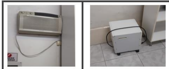
Fotografia 2: Ar-condicionado e desumidificador empregados no ambiente de armazenagem.
